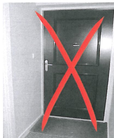
Porte non conforme
